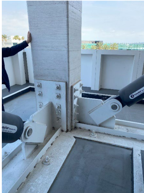
Fotoğraf 7: FRP ile Sargılanmış Kolona Bağlantı
