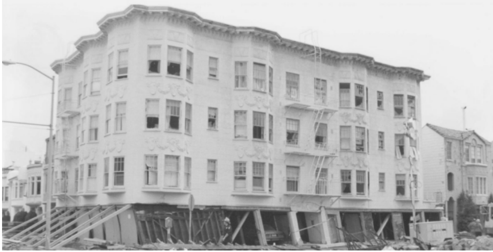
Fotoğraf 1: Yumuşak Katlı Bir Bina Örneği (@David Bonowitz, S.E)
