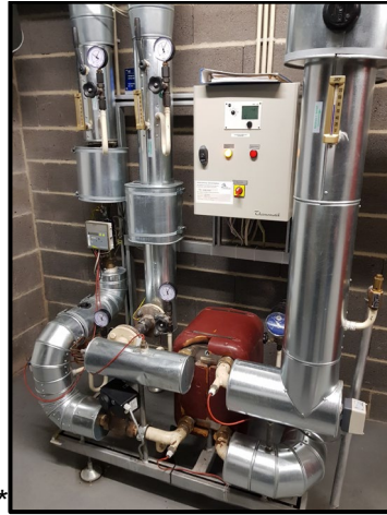
Fotoğraf 33: Bina İçi Teknik Hacimde Doğru Yapılmış Bir Tesisat İzolasyonu
