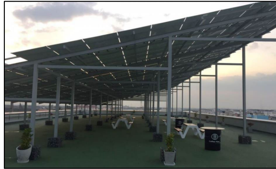
Fotoğraf 34: Yükseltilmiş Konstrüksiyona Yerleştirilmiş Bir Çatı GES Uygulaması
