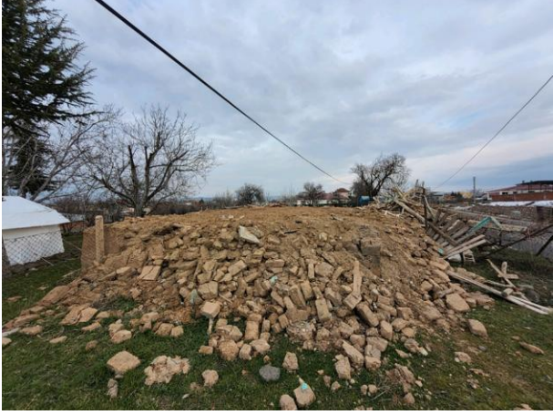
Fotoğraf 26. 177/22 Parsel Genel Görünümü (Yıkılmış Ev)
