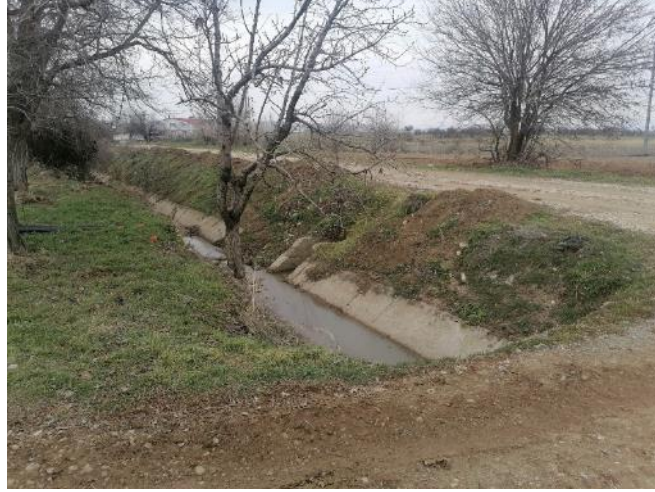
Fotoğraf 110. Parsel EA'sındaki Sulama Kanalı (Parsele dahil değildir.)
