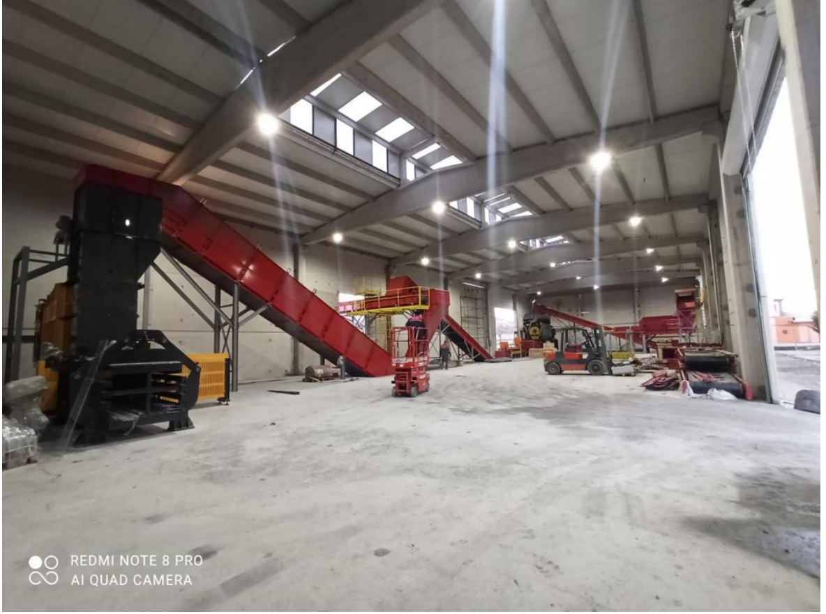
Atıktan Türetilmiş Yakıt Tesisi
