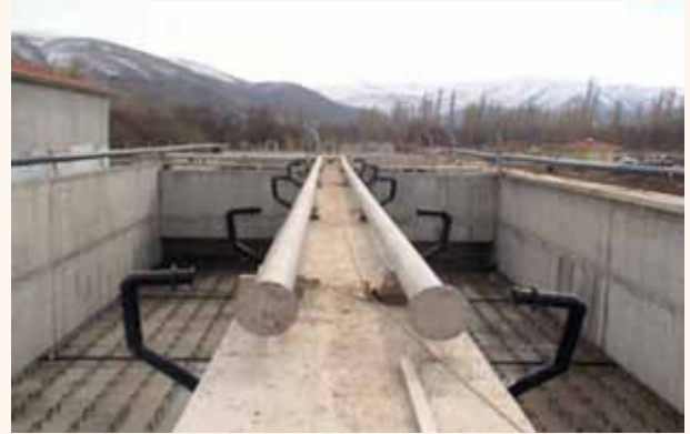
Şekil 28. Atık Su Arıtma Tesisi
