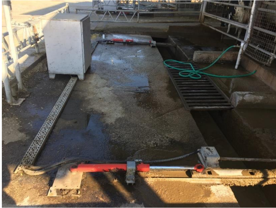
Fotoğraf 16: Bir İşletmede Gübre Sıyırıcı Sistem ve Kanal Fotoğraf: EPTİSA
