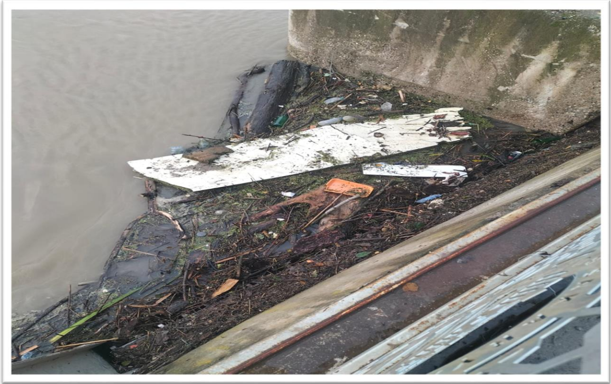
Şekil 35: Hidroelektrik Santrallerde Biriken Deniz Çöpleri
