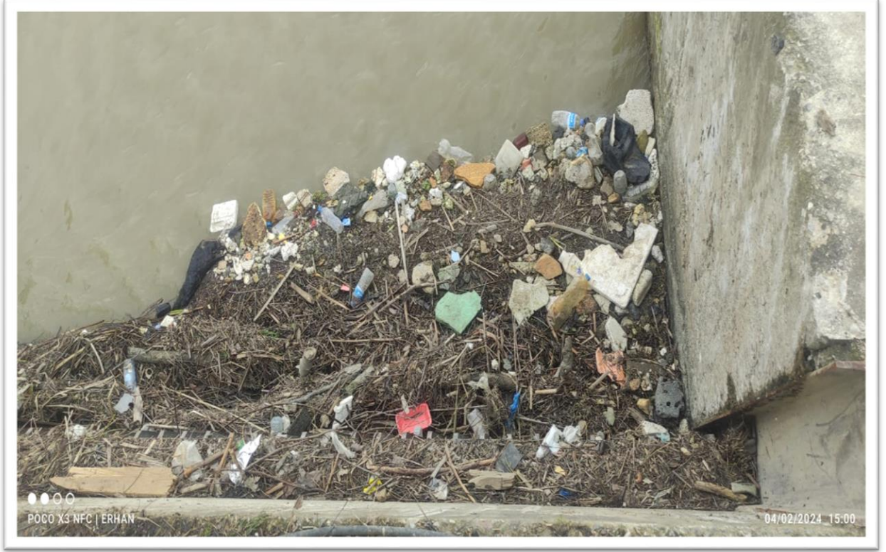
Şekil 31: Hidroelektrik Santrallerde Biriken Deniz Çöpleri
