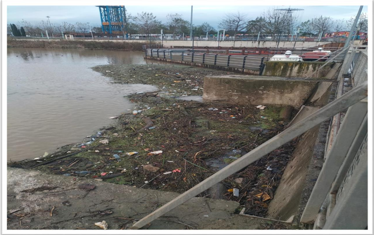
Şekil 33: Hidroelektrik Santrallerde Biriken Deniz Çöpleri
