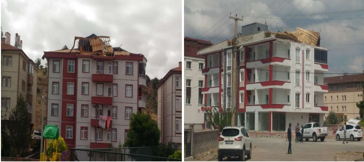
Resim 2-7 İlimizde Rüzgar Afeti nedeni ile meydana gelen çatı hasarları
