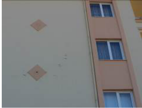
Şekil 24. Hatalı boya uygulaması
