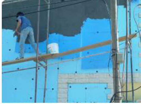
Şekil 21. Yanlış 2.kat sıva uygulaması
