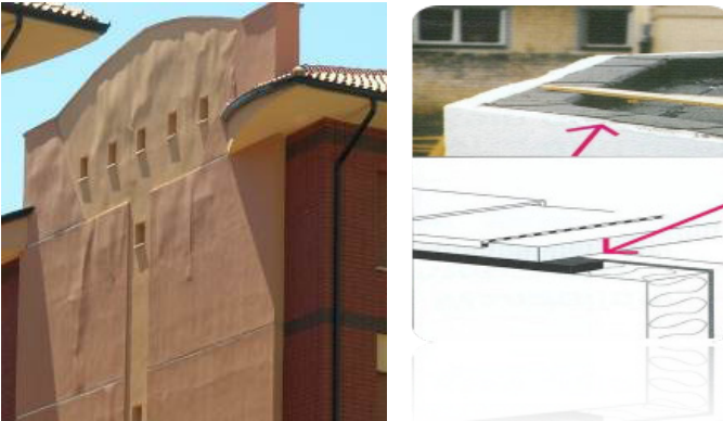
Şekil 31. Hatalı mimari detay çözümü kaynaklı hasarlar
