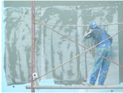
Şekil 22. Donatı filesi bindirmelerinin yapılmaması
