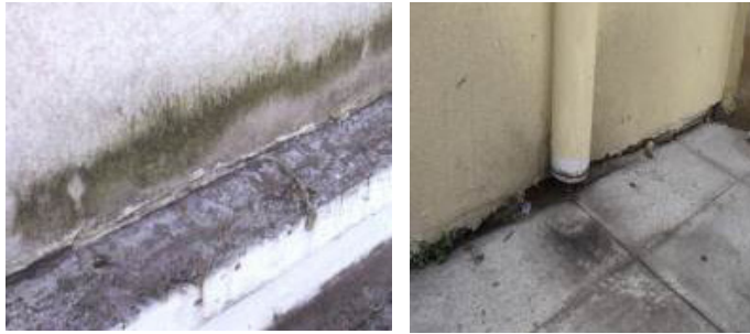
Şekil 33. Hatalı zemin detay çözümü kaynaklı hasarlar
