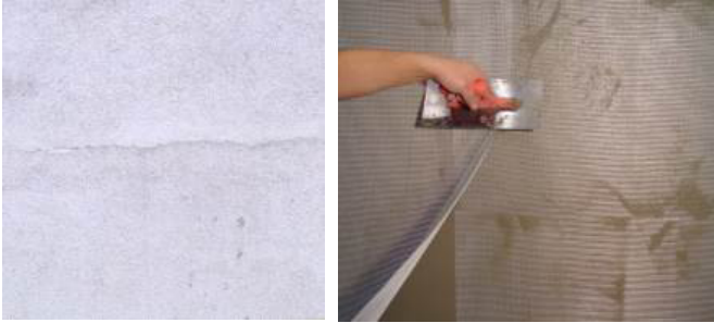
Şekil 30. File bindirmelerinin yapılmaması kaynaklı hasarlar
