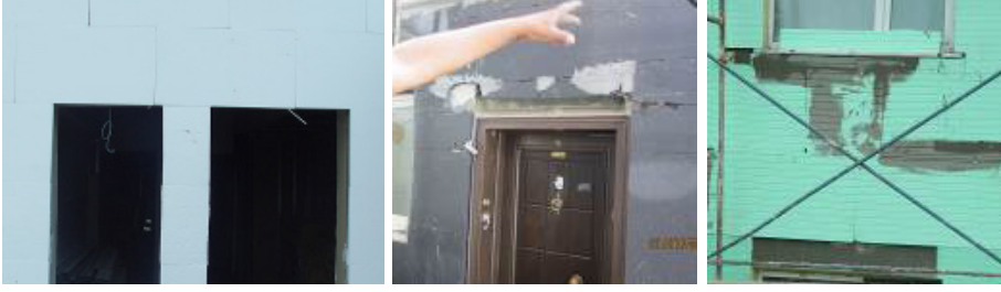
Şekil 15. Pencere, kapı köşelerinde yanlış levha yerleştirme örneği
