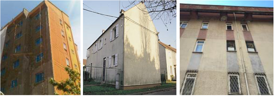
Şekil 9. Alt yüzey problemleri
