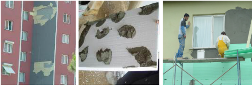
Şekil 28. Alt yüzeyin düzeltilmemesi kaynaklı hasarlar
