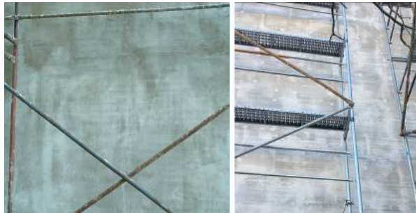
Şekil 20. İnce sıva uygulamasından kaynaklı hata
