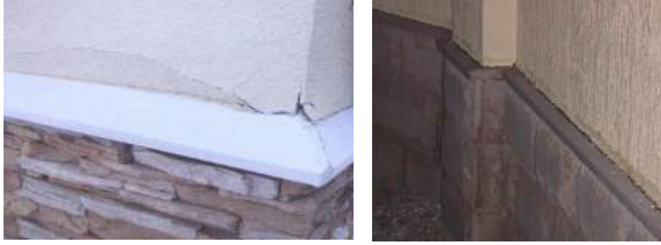
Şekil 32. Mastik kullanılmaması kaynaklı hasarlar
