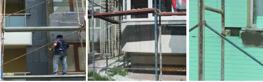
Şekil 10. Yanlış iskele bağlantı elemanlarının kullanılması
