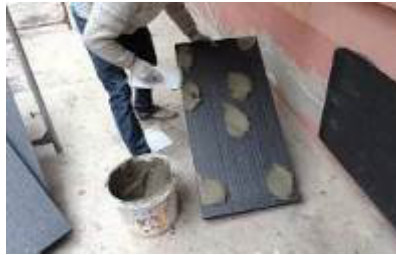
Şekil 14. Yanlış yapıştırma sistemi kullanılması
