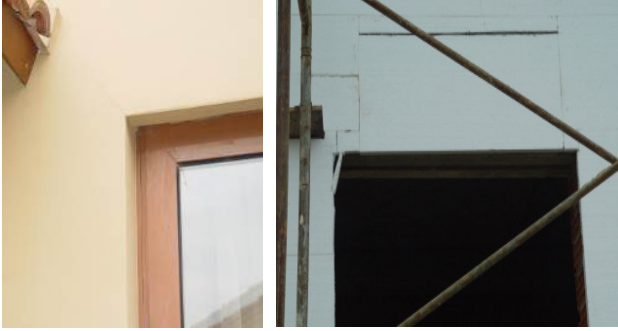
Şekil 29. Pencere kenarları L uygulanmamasından kaynaklı oluşmuş hasarlar
