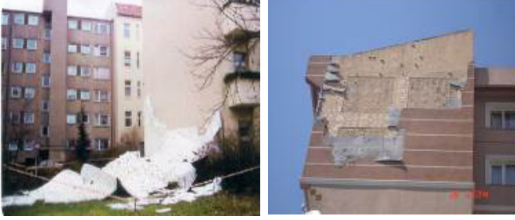
Şekil 26. Alt yüzey temizliğinin uygun yapılmaması kaynaklı hasarlar
