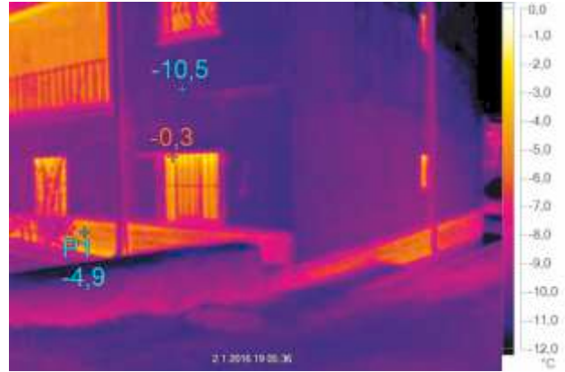
Kot seviyesi altı duvarlar yalıtılmamış
