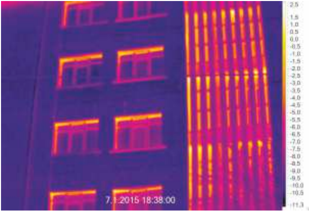
Cephedeki kolonlar yalıtılmamış
