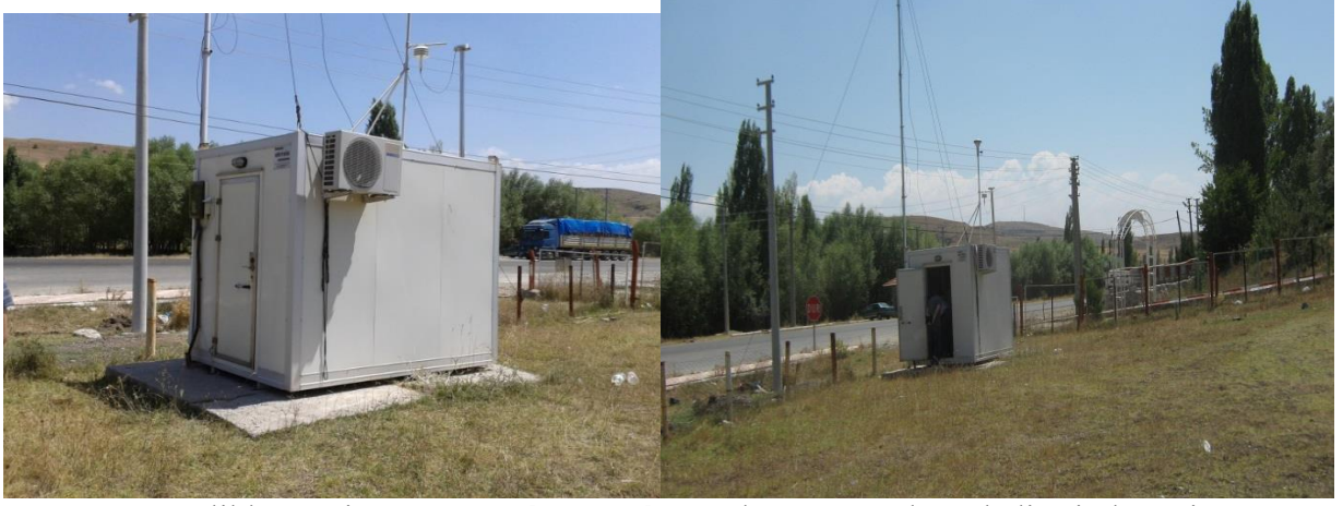
Resim 11: Çelikler Seyitömer Termik Santrali (Jandarma yanı) hava kalitesi ölçüm istasyonu
