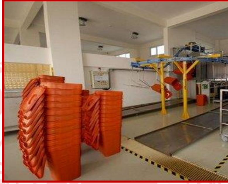
Fotoğraf-7. : Tıbbi Atık Sterilizasyon Tesisinin İç Mekan Görüntüsü
