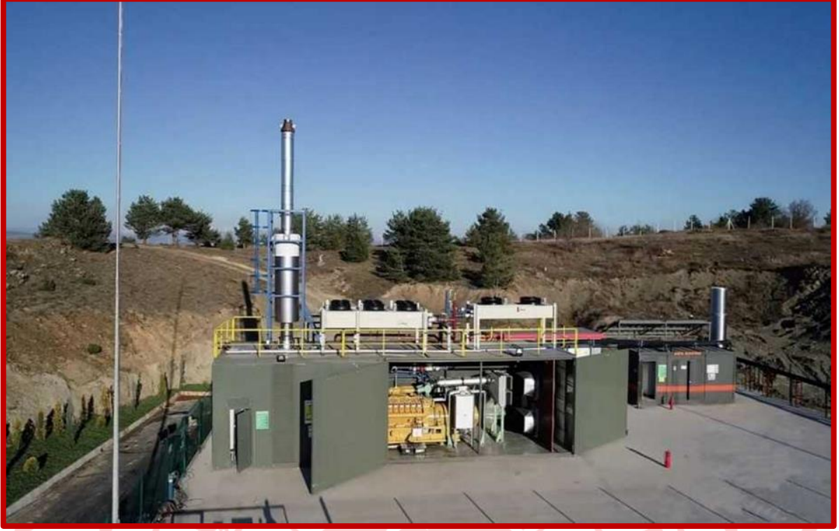
Fotoğraf-6. : Elektrik Üretim Tesisi
