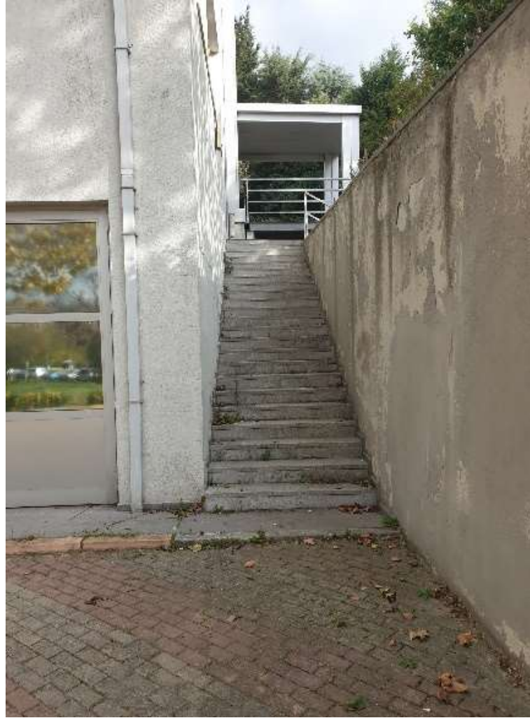
Şekil 19 Uygun korkuluk olmayan merdivenler
