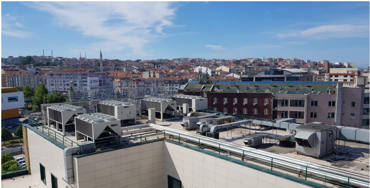
Fotoğraf 2. Soğutma Gruplarının Daha Verimli Soğutma Grupları ile Değiştirilmesi
