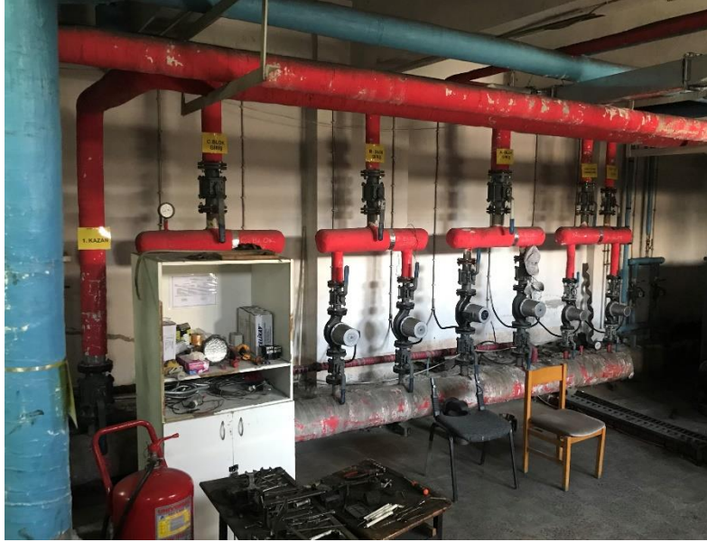
Fotoğraf 3: Değişecek Resirkülasyon Pompaları
