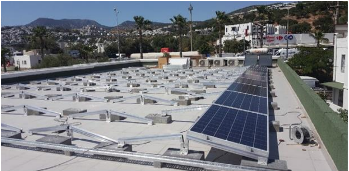
Şekil 2: Çatı tipi PV Panel Modüllerinin Temsili Gösterimi
