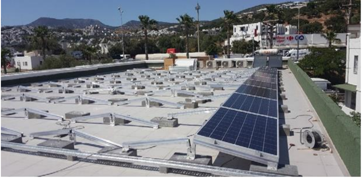
Şekil 2: Çatı tipi PV Panel Modüllerinin Temsili Gösterimi
