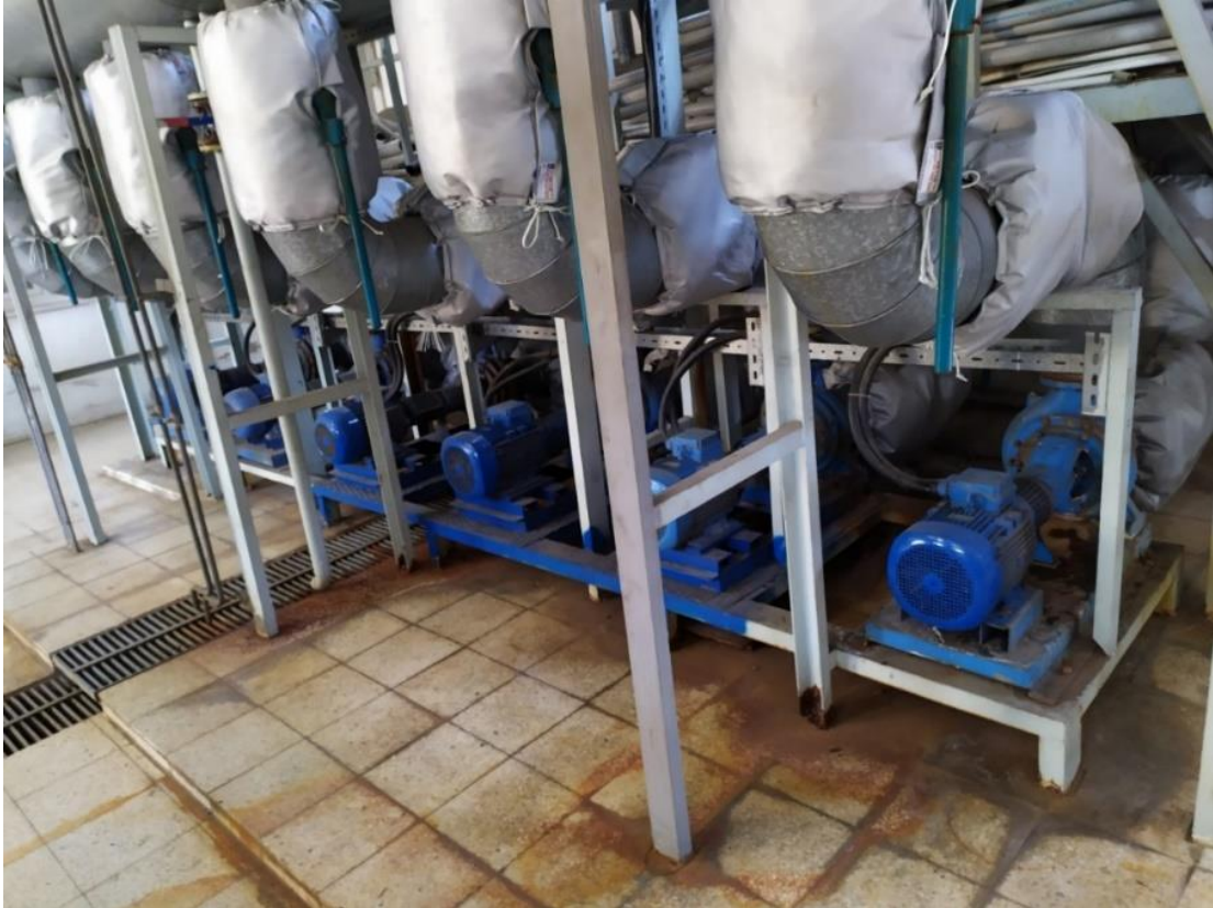
Fotoğraf 4: Değiştirilecek Gidiş-Dönüş Isıtma Resirkülasyon Pompaları
