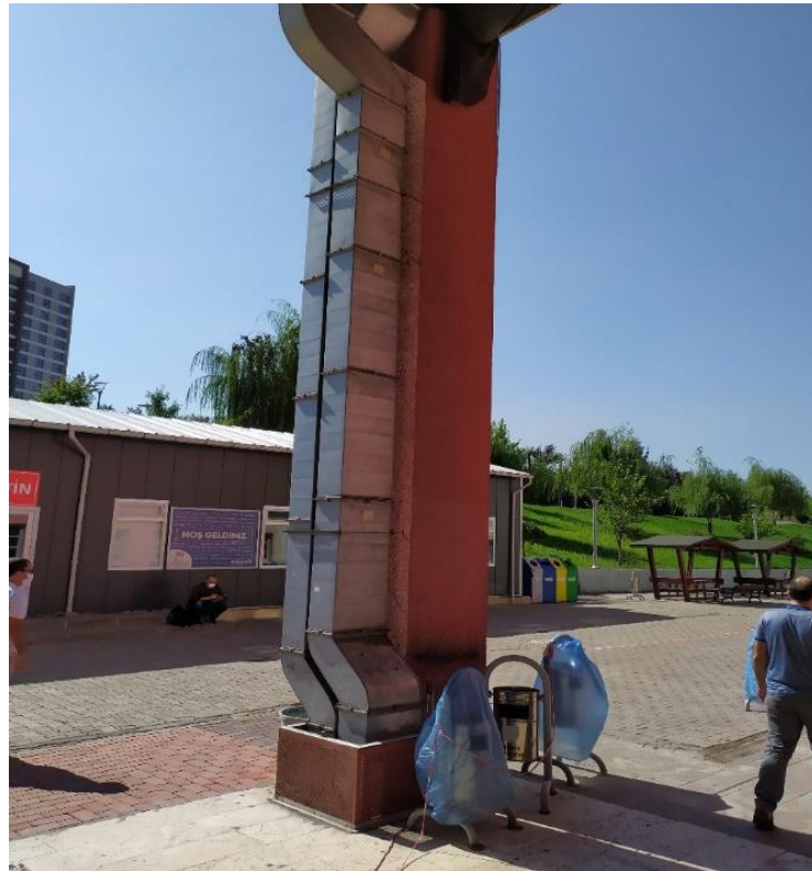
Fotoğraf 2: Mühendislik Fakültesinde Dışarıda Bulunan Hava Kanalı (İzole Edilecek)
