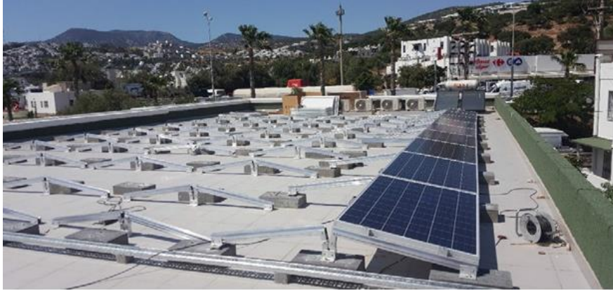
Şekil 2: Çatı tipi PV Panel Modüllerinin Temsili Gösterimi
