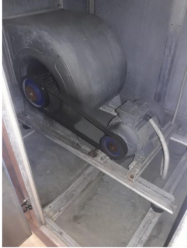
Fotoğraf 5. Klima Santrali ve Egzoz Aspiratörlerinin Fan Motorlarının Verimli Motorlarla Değiştirilmesi
