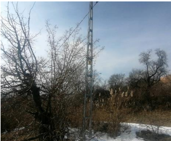
Fotoğraf 72. Parsel İçerisindeki Elektrik İletim Hattı
