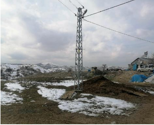
Fotoğraf 86. Parselin Yakınındaki Elektrik İletim Hattı
