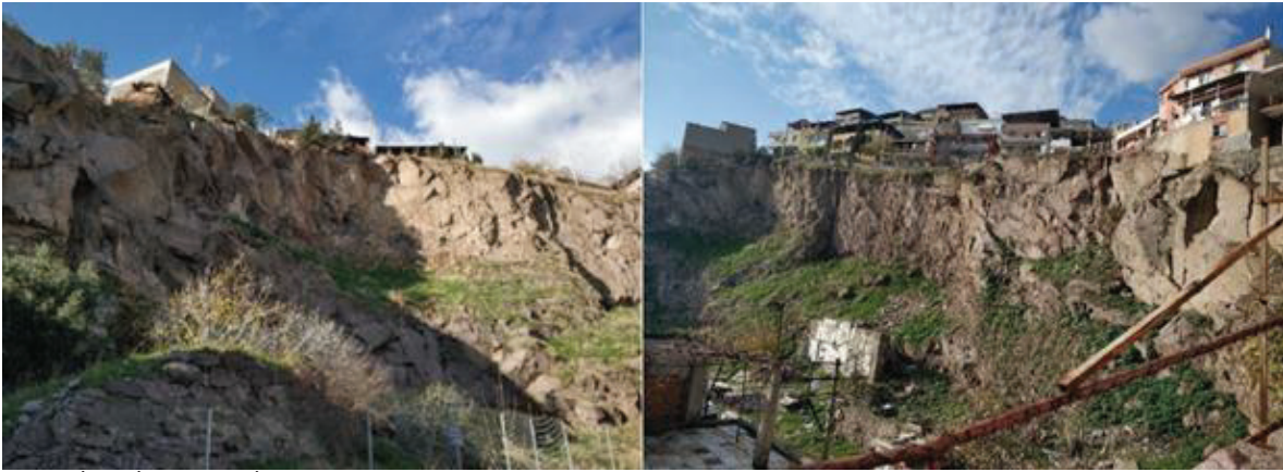
Resim 2.3. İzmir İli, Bayraklı İlçesi, Çiçek Mahallesi'nde Kaya Düşmesi Afeti Nedeniyle 07.11.2019 Tarih, 2019/1756 Sayılı Cumhurbaşkanlığı Kararı ile Afete Maruz Bölge İlan Edilen Alanı (AMB-1) Gösterir Fotoğraflar (İzmir AFAD, 2019)
