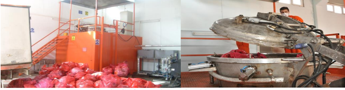
Şekil C.18- Tıbbi Atık Sterilizasyon Tesisi.
