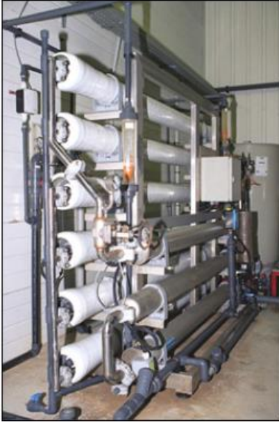
Şekil 4.19: Ters ozmoz tesisi
