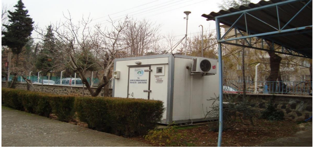
Şekil 10. Gaziantep Hava Kalitesi Ölçüm İstasyonu
