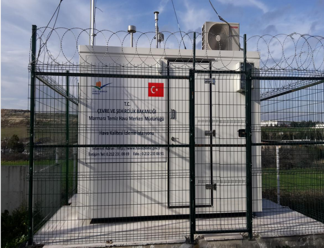
Hava Kalitesi İzleme İstasyonu
