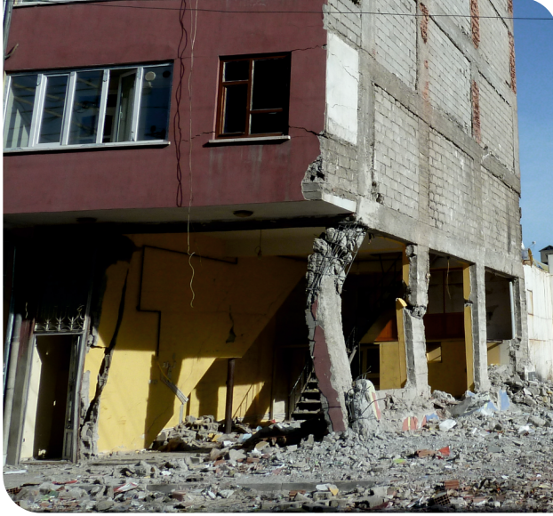
Bitişik bina yıkılırken kolonlarına çarpması sonucu hasar gören bir bina. Artçı depremlerde dahi ayakta kalmayı başarmış
