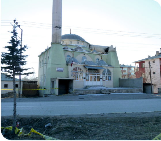
Caminin betonarme minarelerinden biri tamamen yıkılmış diğeri ise hasarlı durumda (Erciş)
