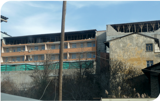
Kalkan duvarlarda hasar
