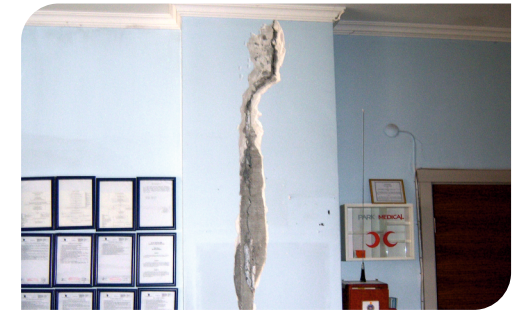
Dilatasyonla ayrılmış binada iki kolon arasında sıva çatlağı
