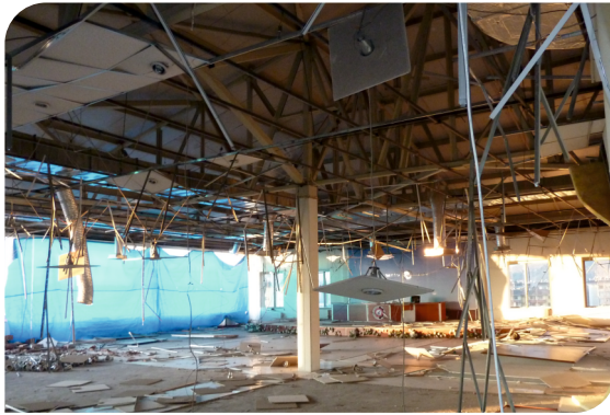
Asma tavanlarda gözlenen hasar. Çatı tabliyesinin üzerinde sonradan çelik konstrüksiyon ile yapılmış bölümde asma tavanlar tamamen göçmüş durumda. Betonarme taşıyıcı sistem üzerine çelik malzeme ile ilave edilen bu katın rijitliğinin bir alt kata göre farklı olması ve çok daha fazla ötelenmesi bu kattaki asma tavan hasarının fazla olmasına neden olmuştur. Asma tavan panellerin içine oturtulduğu metallerin bağlantıların gerektiği gibi yapılmaması kolayca kopmalara ve dökülmelere neden olabilmekte
