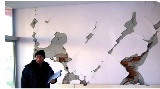
Bölme duvarlarda çok miktarda kesme çatlakları
