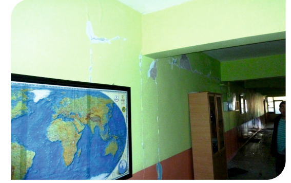
Zemin kat koridorlarında taşıyıcı çerçeve ile bölme duvarları arasında sıva çatlakları
