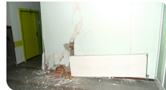
Döşemeye oturan dolgu duvarda hasar
