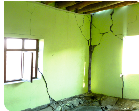
Tek yönlü merteklerle mesnetlenmiş dış duvarlar, birbirine dik doğrultuda birleşen dış duvarlarda yetersiz birleşimler. Merteklerin oturmadığı diğer duvar düzlem dışına ayrılmış
