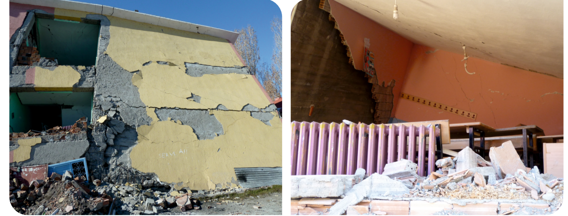
Van depreminde yıkılan Gedikbulak İ.Ö.O. Yapının sadece sol arka (Kuzey-Doğu) cephesinde Merdiven kenarı ile bina arkasına L şeklinde yerleştirilmiş betonarme perdeler var. Bu durum binada burulma (rijitlik) düzensizliği yaratmakta
