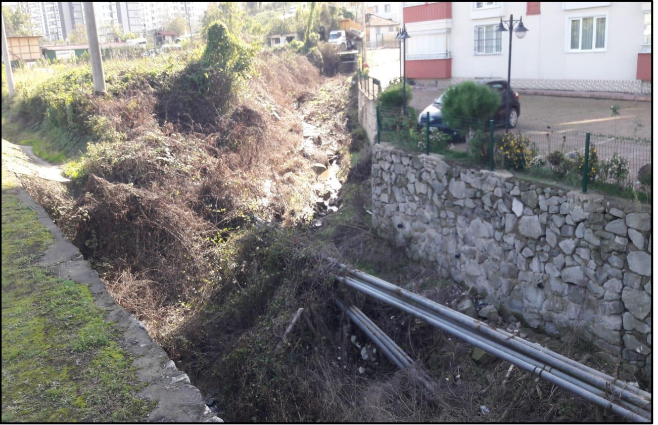
Resim 5.7: Fatsa İlçesi Dolunay Mah. Yapraklı Deresi Terfi Merkezi Yanı
