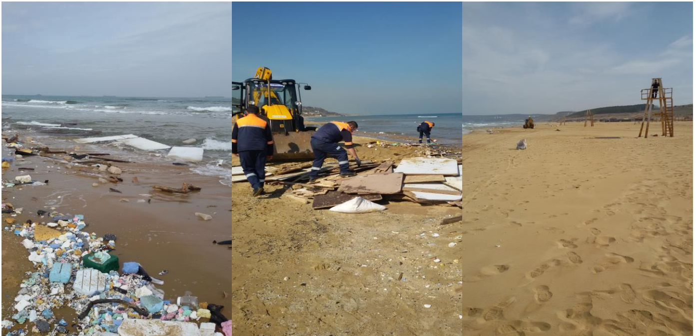
Şekil 59: 2016 yılında Kilyos plajındaki inşaat atıklarının temizlenmesi
