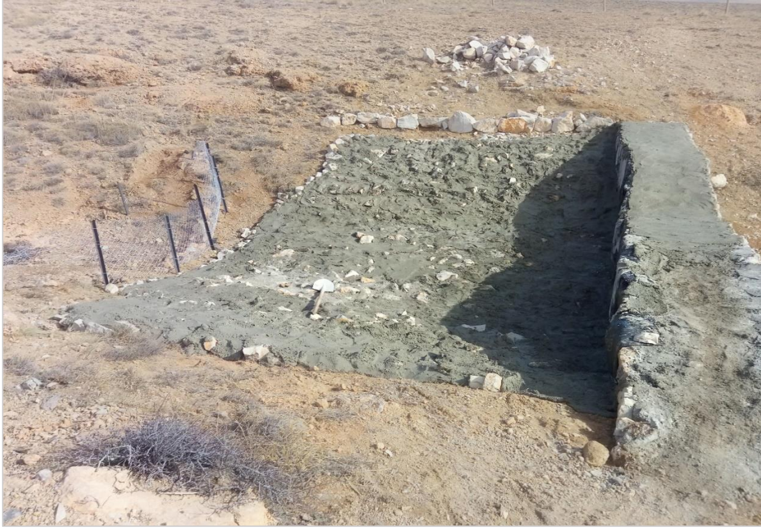
Görsel 21. Model Mera Sahasında dere içine tesis edilen su hasadı yapısı
