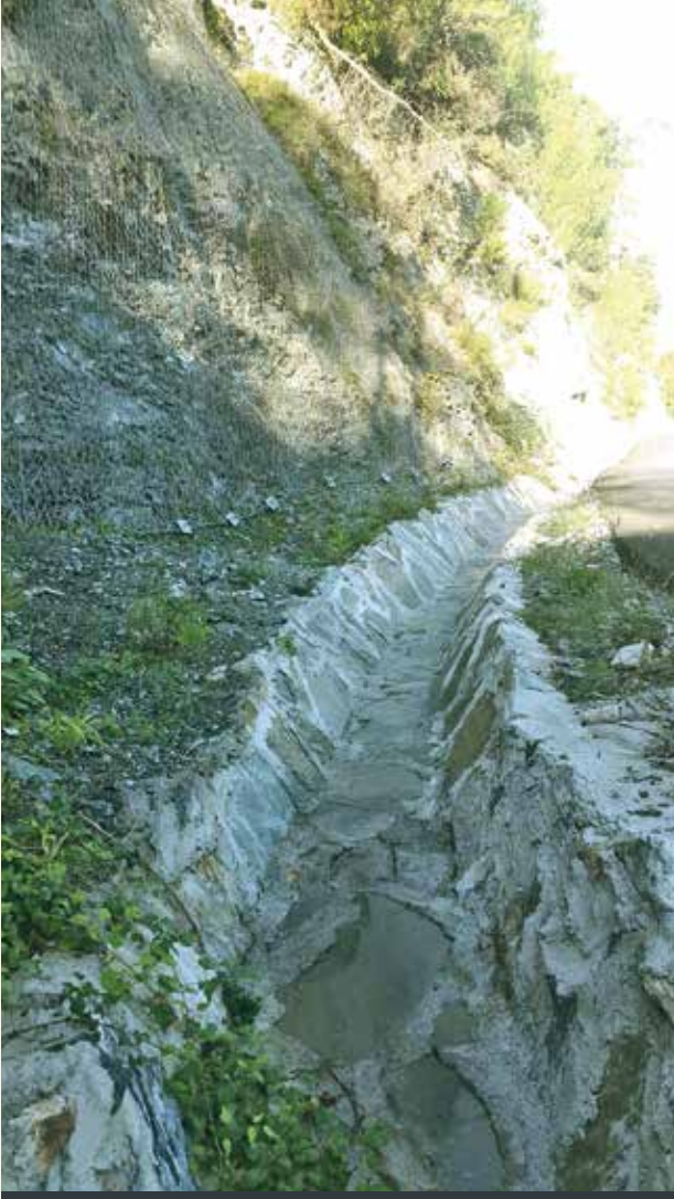
Taş pere kaplamalı açık drenaj kanalı
