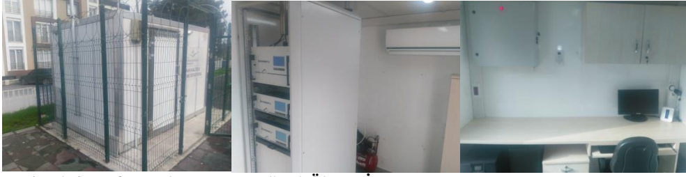
Resim A.2- Tokat-Erbaa Hava Kalitesi Ölçüm İstasyonu
