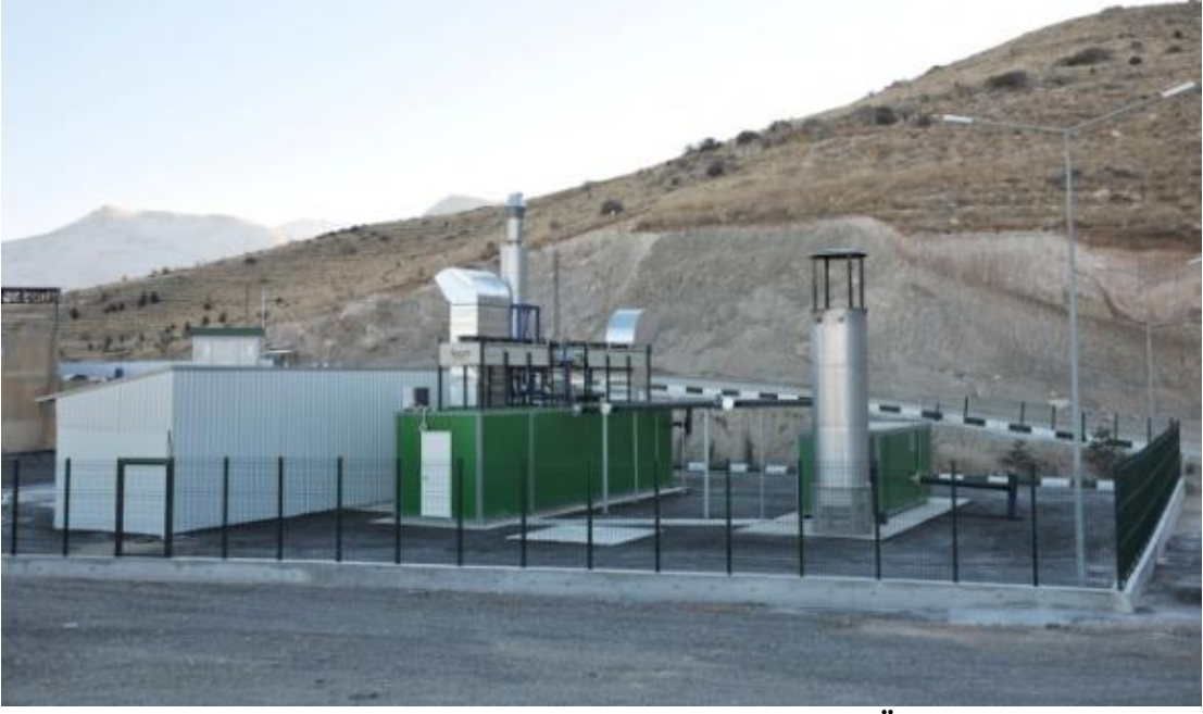
Resim C.4 - Mwm Tcg 2020 V12 Biyogaz Motoru Ve Booster Ünitesi
