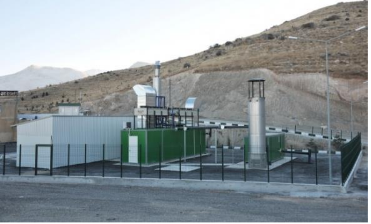
Resim C.6-Mwm Tcg 2020 V12 Biyogaz Motoru Ve Booster Ünitesi
