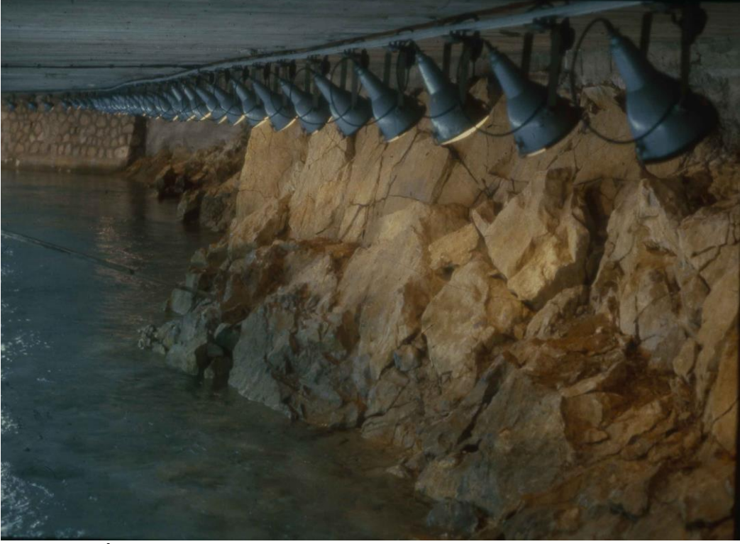
Resim B.2-İçme Suyu Kaynağı Malatya –Kaptaj
