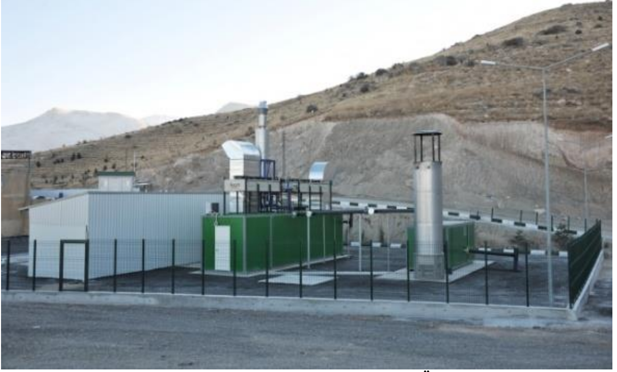
Resim C.6-Mwm Tcg 2020 V12 Biyogaz Motoru Ve Booster Ünitesi
