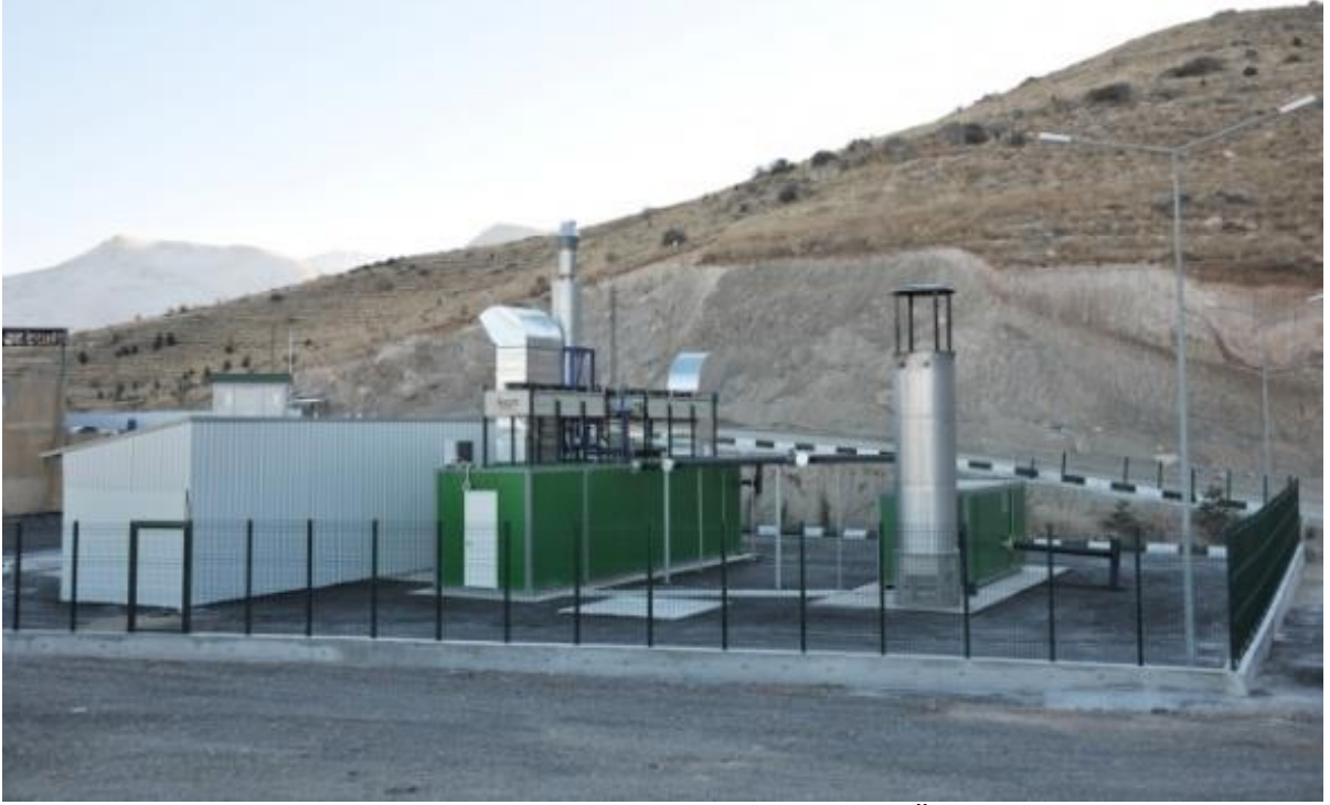
Resim C.6-Mwm Tcg 2020 V12 Biyogaz Motoru Ve Booster Ünitesi
