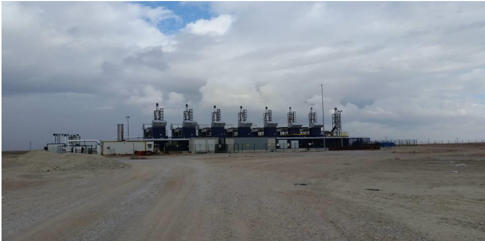
Resim 15– Kaşınhanı Metan Gazından Elektrik Enerjisi Üretim Tesisi (Konya Büyükşehir Belediyesi, 2025)
