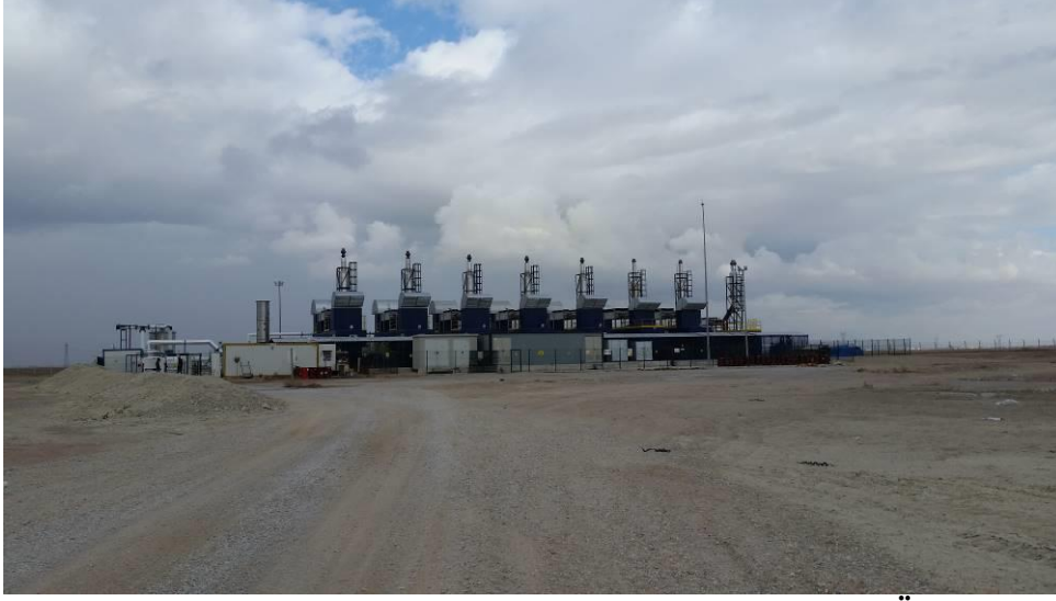
Resim.15 – Kaşınhanı Metan Gazından Elektrik Enerjisi Üretim Tesisi (Konya Büyükşehir Belediyesi, 2024)
