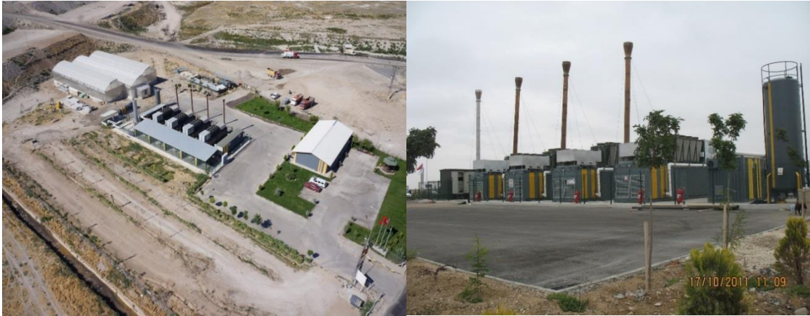
Resim C.13 – Aslım Metan Gazından Elektrik Enerjisi Üretim Tesisi (Konya Büyükşehir Belediyesi, 2023)
