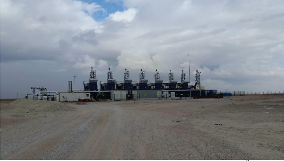
Resim C.15 – Kaşınhanı Metan Gazından Elektrik Enerjisi Üretim Tesisi (Konya Büyükşehir Belediyesi, 2023)
