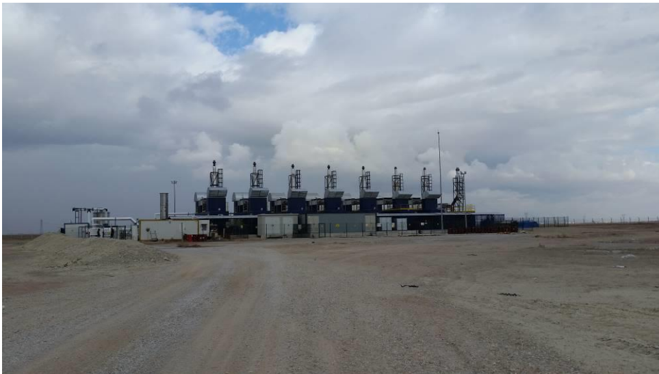
Resim C.15 – Kaşınhanı Metan Gazından Elektrik Enerjisi Üretim Tesisi (Konya Büyükşehir Belediyesi, 2022)
