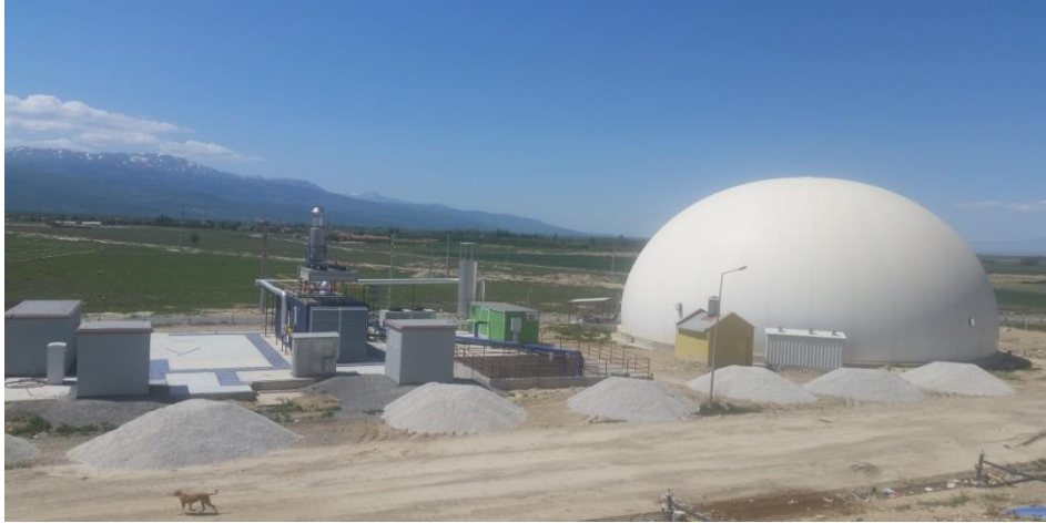
Resim C.14 – Akşehir Metan Gazından Elektrik Enerjisi Üretim Tesisi (Konya Büyükşehir Belediyesi, 2022)
