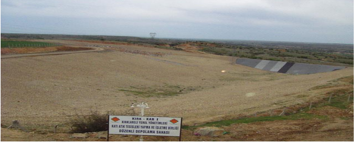
Resim 1 - Kırklareli İli Katı Atık Bertaraf Tesisi
