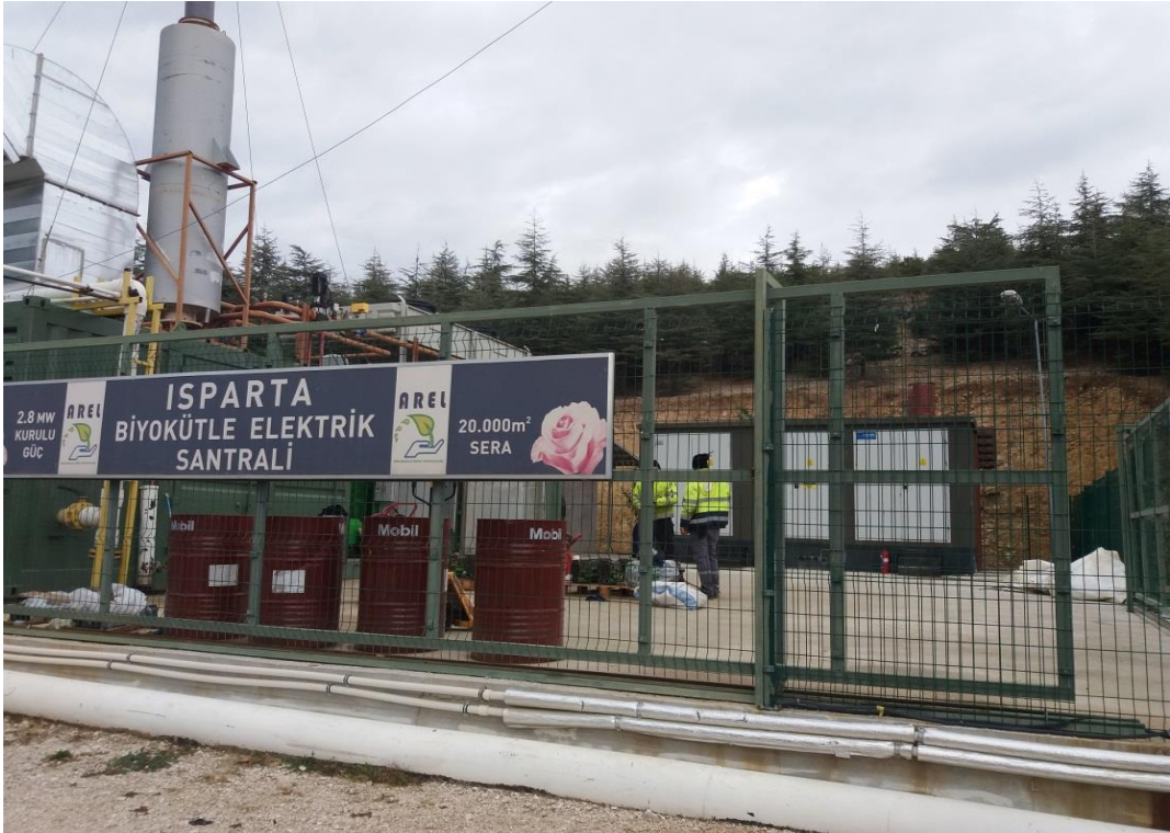
Resim C.8 - Göller Bölgesi Belediyeler Birliğine ait Koçtepe Düzenli Katı Atık Depolama Tesisi içerisinde yer alan biyokütle enerji üretim santrali
