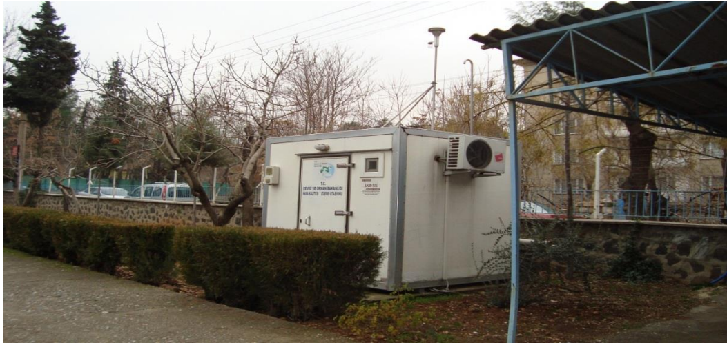
Şekil 7. Gaziantep Hava Kalitesi Ölçüm İstasyonu
