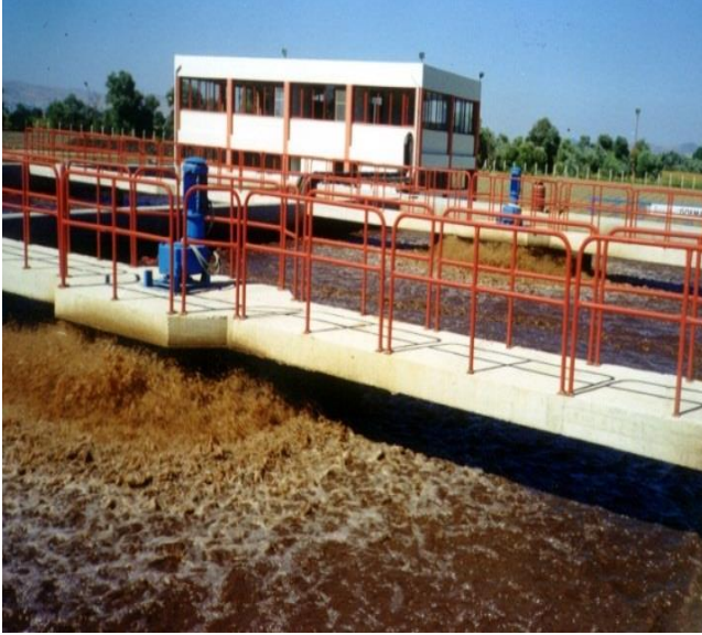
Resim 3- Salça Fabrikası Arıtma Tesisii
