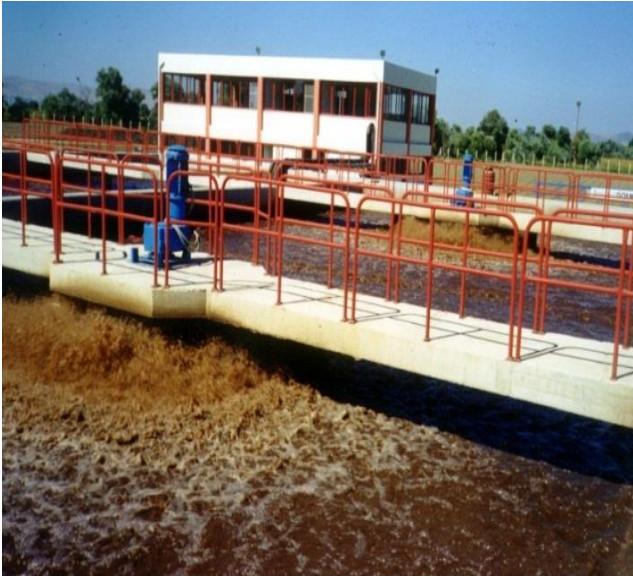
Resim 3- Salça Fabrikası Arıtma Tesisi
