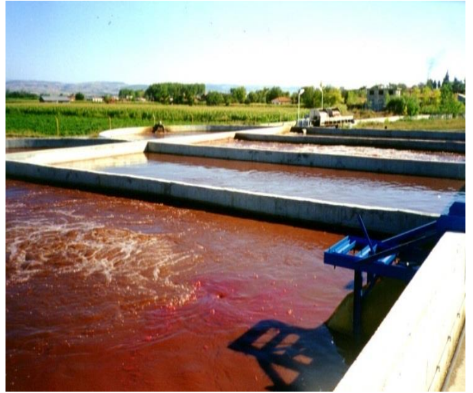
Resim 4- Salça Fabrikası Arıtma Tesisi
