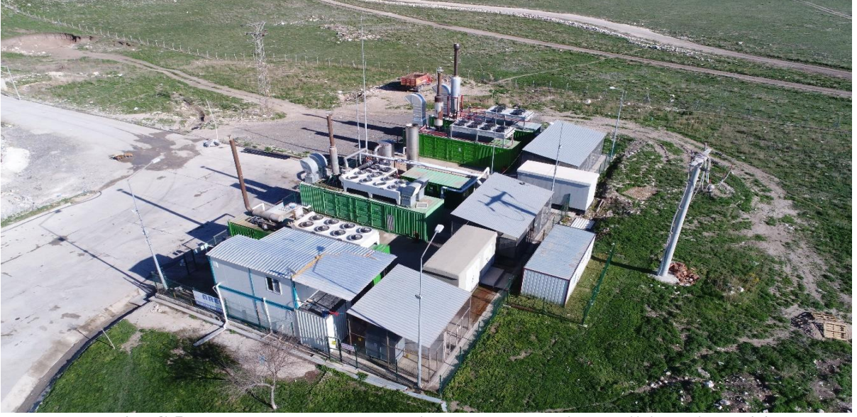
Resim C.5 - Katı atıklardan oluşan biyogazdan elektrik enerjisi üretim tesisi
