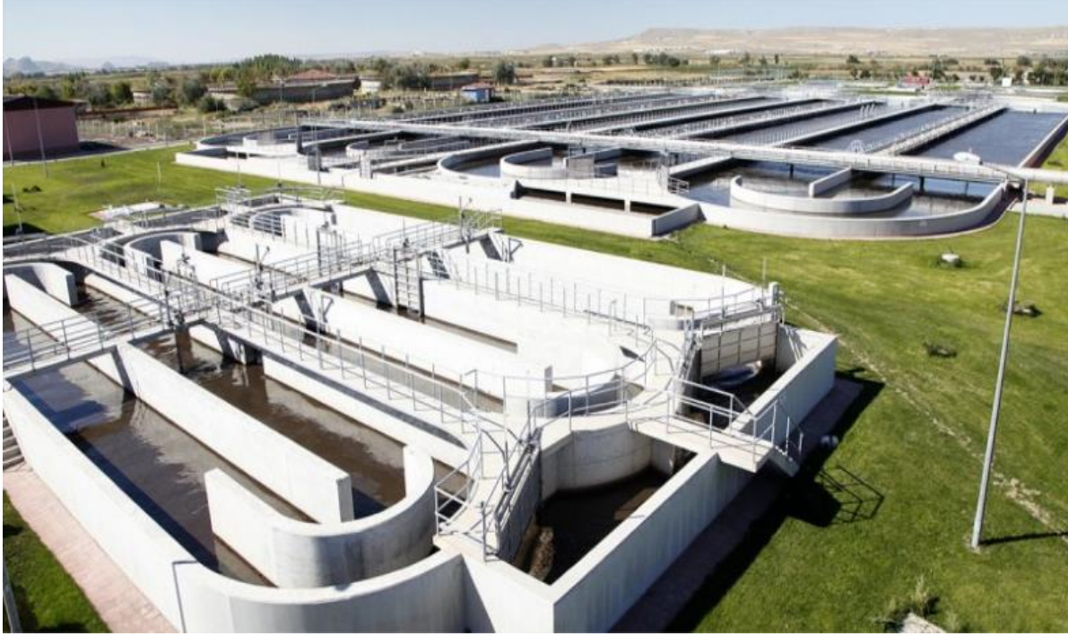
Resim B.2 - Merkez atıksu arıtma tesisi
