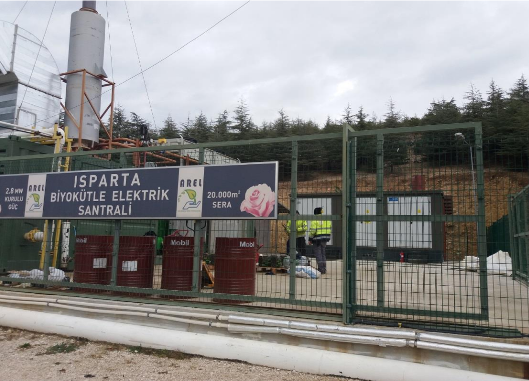
Resim 5 - Göller Bölgesi Belediyeler Birliğine ait Koçtepe Düzenli Katı Atık Depolama Tesisi içerisinde yer alan biyokütle enerji üretim santrali
