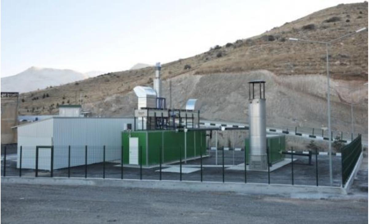
Resim C.6-Mwm Tcg 2020 V12 Biyogaz Motoru Ve Booster Ünitesi
