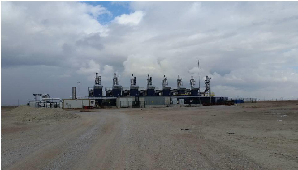
Resim C.15 – Kaşınhanı Metan Gazından Elektrik Enerjisi Üretim Tesisi (Konya Büyükşehir Belediyesi, 2021)
