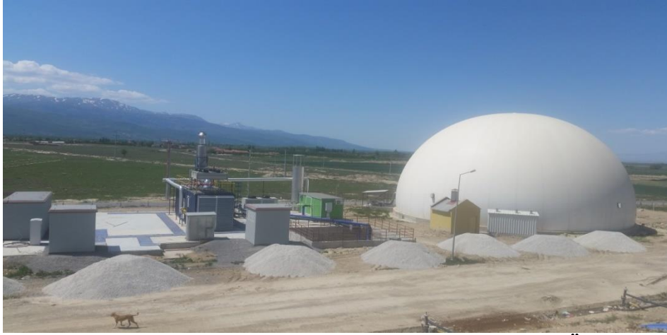
Resim C.14 – Akşehir Metan Gazından Elektrik Enerjisi Üretim Tesisi (Konya Büyükşehir Belediyesi, 2021)
